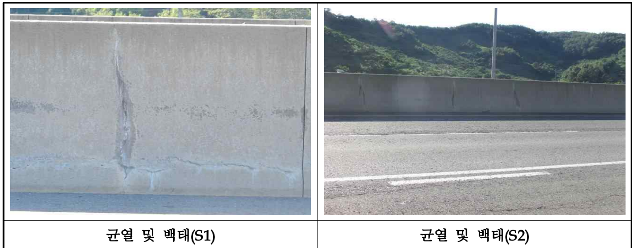
【사진 3.2.19】 난간 및 연석 손상현황(대구)
