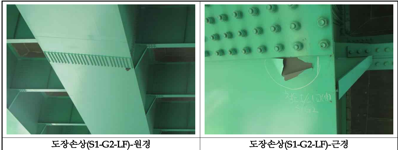
【사진 3.2.3】 강박스 거더 외부 손상현황(대구)
