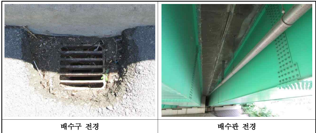
【사진 3.3.16】 배수구 및 배수관 전경(부산)
