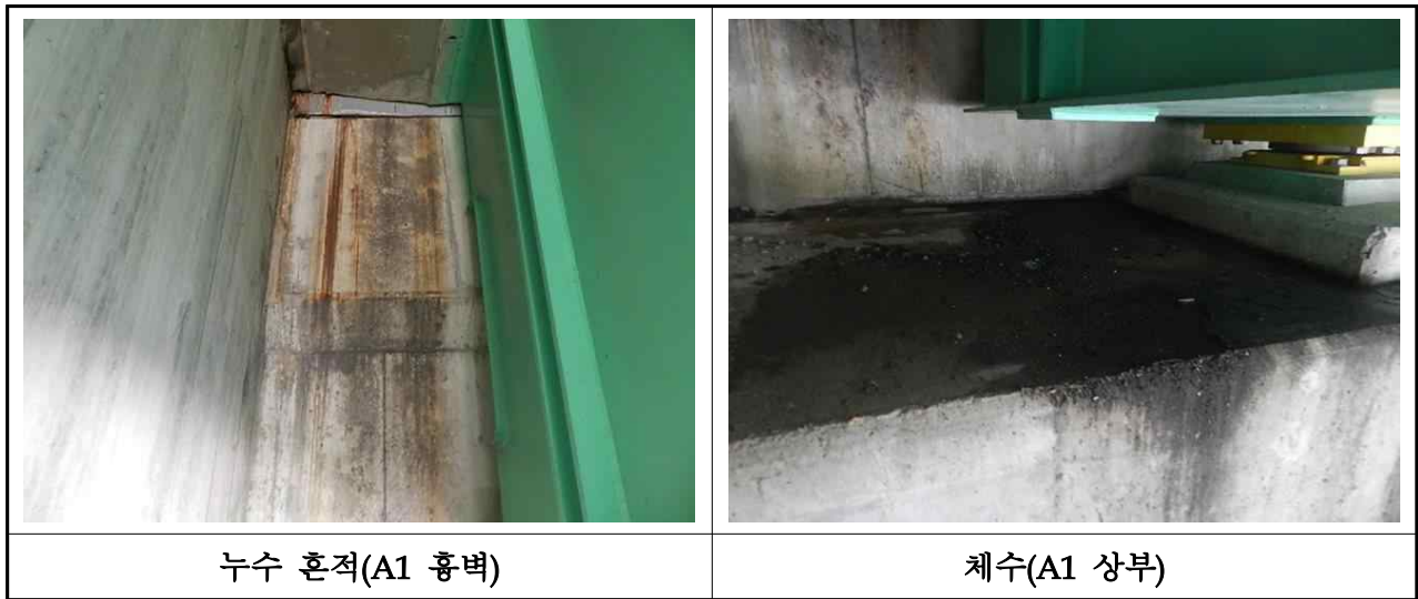
【사진 3.3.5】 교대 손상현황(부산)
