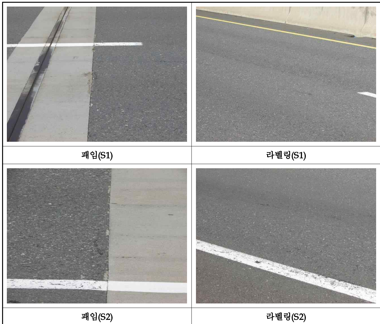
【사진 3.3.15】 교면포장 손상현황(부산)
