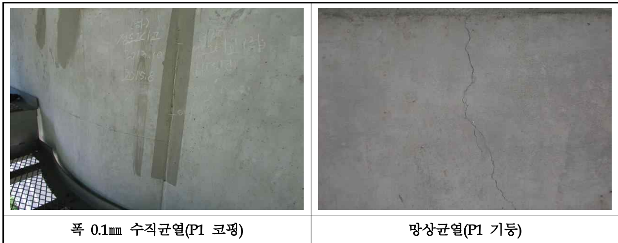
【사진 3.3.7】 교각 손상현황(부산)
