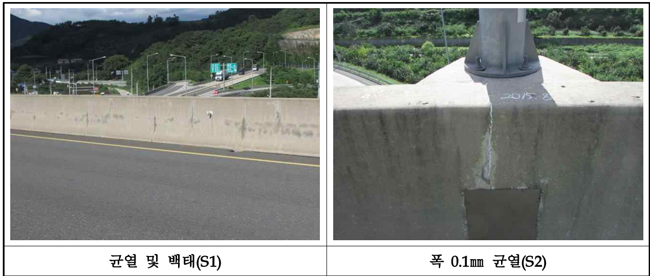
【사진 3.3.19】 난간 및 연석 손상현황(부산)
