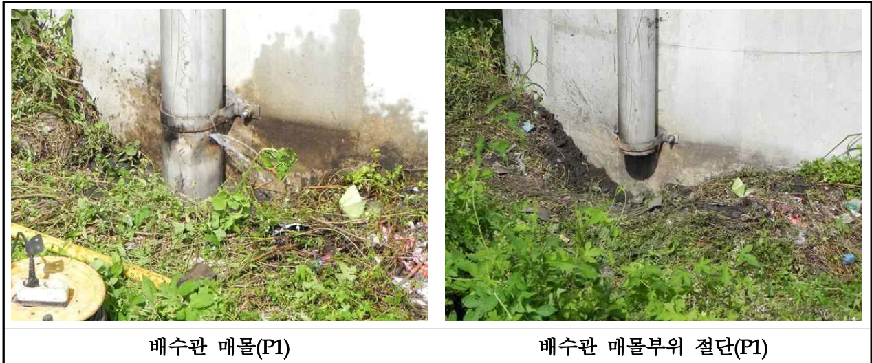
【사진 3.2.17】 배수시설 손상현황(대구)
