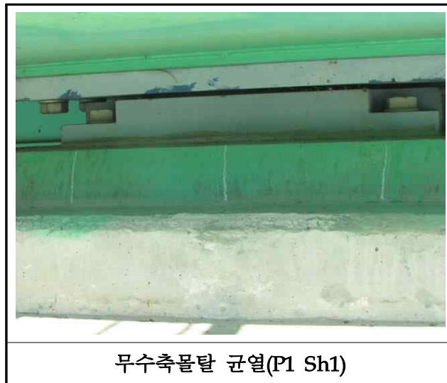
【사진 3.3.9】 교량받침 손상현황(부산)
